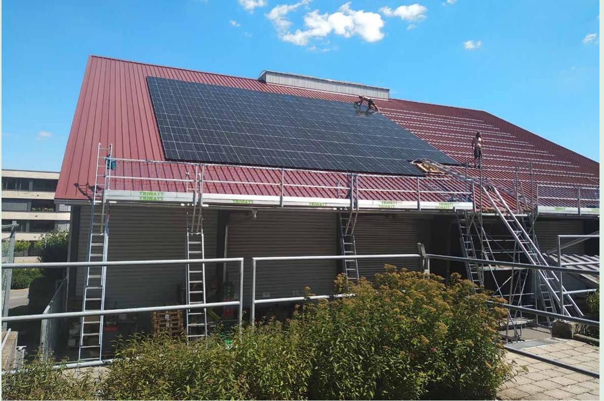
Kooperationsprojekt für den Klimaschutz: Die Ökumenische Energiegenossenschaft realisierte in Schwäbisch Hall eine Photovoltaik-Anlage für die Samariterstiftung.
